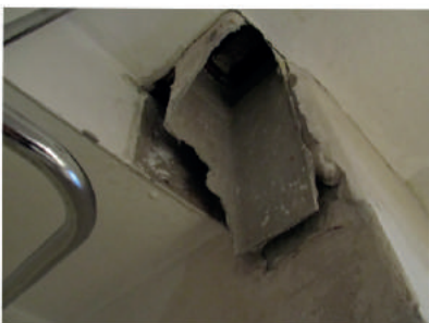
Abgebrochener Lüftungsschacht aus Asbestzement
